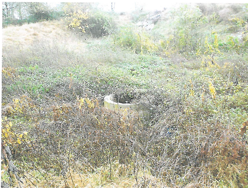
Fot. nr 9. Studzienka zbiorcza na wody opadowe. (30.10.2009r.)
